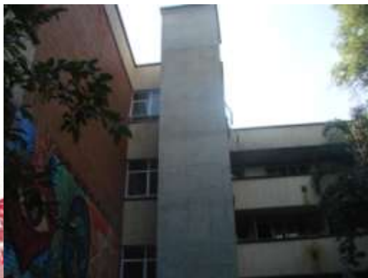
Ascensor edificio 320 Facultad de Ciencias Exactas CUV.
